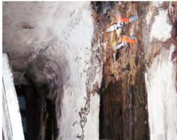
2本の注入プラグの周辺から水が噴きだしてくる
